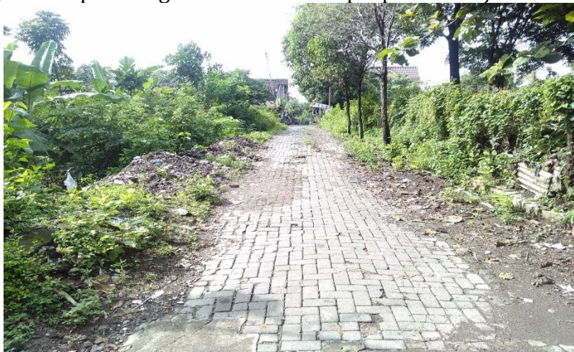
Gambar 2 Foto Kondisi Saluran dan Jalan Paving (Sumber: dokumentasi pribadi, 2021)
