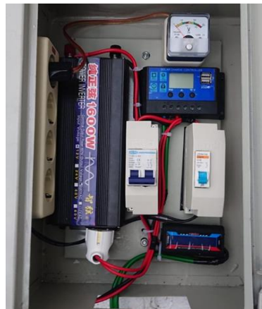
Gambar 6. System instrument kelistrikan PLTS yang telah dirangkai di dalam box panel surya
