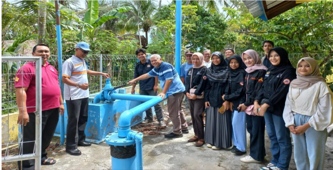
Gambar 5. Stasiun Sumber Air Distribusi Sawah di Gampong Luthu Aceh Besar
